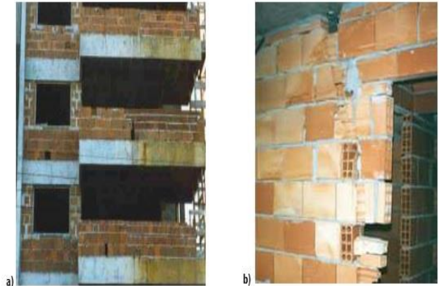
Figura 1 – Alvenaria de vedação tradicional: a) baixa qualidade da execução e dos materiais, b) deficiente padronização
