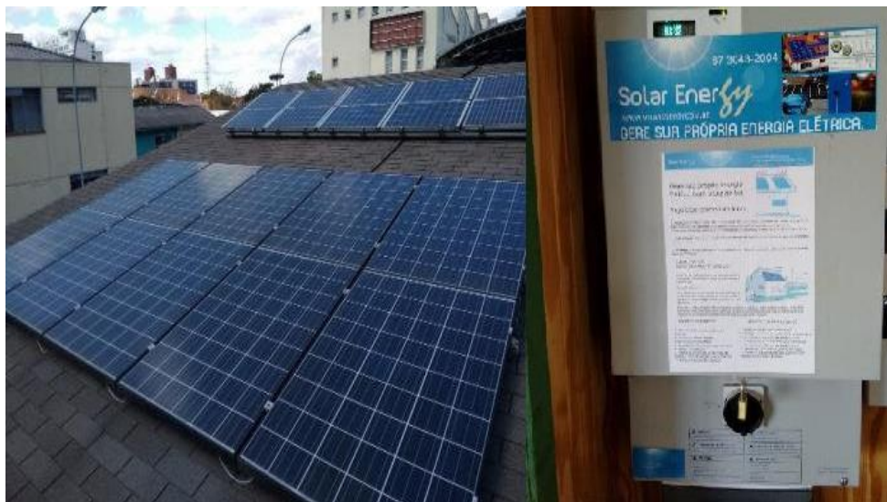
Figura 4. Sistema fotovoltaico aplicado ao Escritório Verde.
