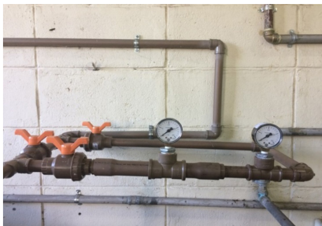
(Figura 9- Tubo de Venturi)
