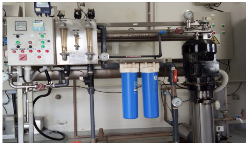
Figura 2. Sistema de Osmose Reversa. Fonte: autor (2017).
