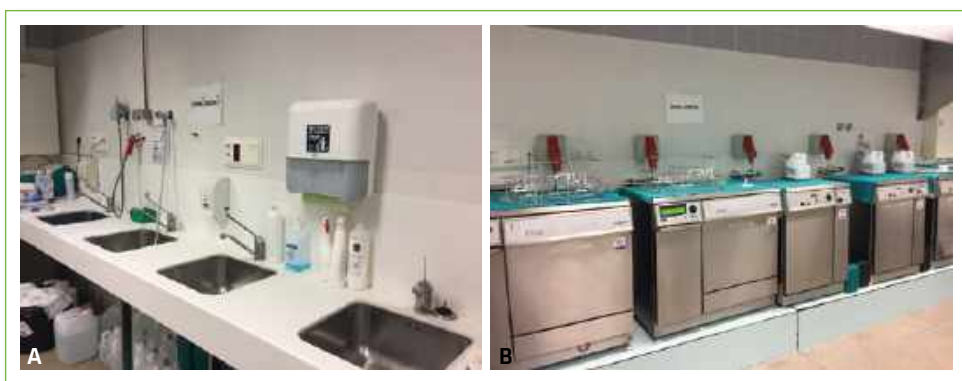
FIGURA 3. Ejemplo de sala de desinfección. A) Zona sucia con 4 fregaderos*. B) Zona limpia con 5 lavadoras de desinfección automática*.
