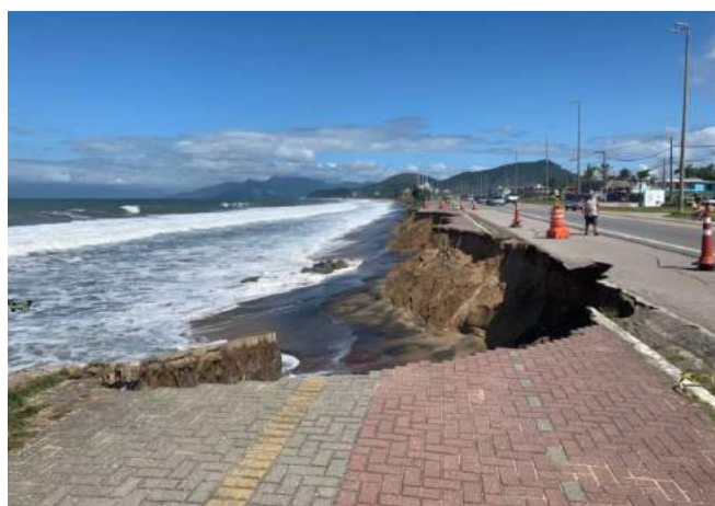
Fig. 2.23 - Erosão costeira que atingiu a praia do Massaguaçu na cidade de Caraguatatuba - SP e causou prejuízos na calçada e rodovia Rio-Santos. (Foto: João Mota/TV Vanguarda).
