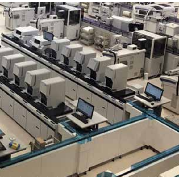
Área técnica da nova sede do Laboratório Sabin, em Brasília (DF)
