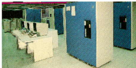
Figura 2.2 – Sala de C.P.D. com mainframes e terminais
