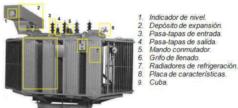
Elementos que componen el transformador sumergido en aceite con depósito de expansión.
