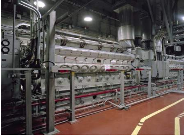
Figura 37. Generador diésel de emergencia
