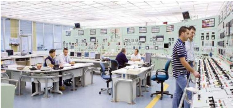
Figura 39. Sala de Control
