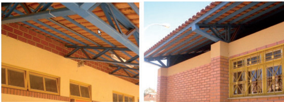
Ventilação sobre forro utilizando tijolos furados e abertura livre.
