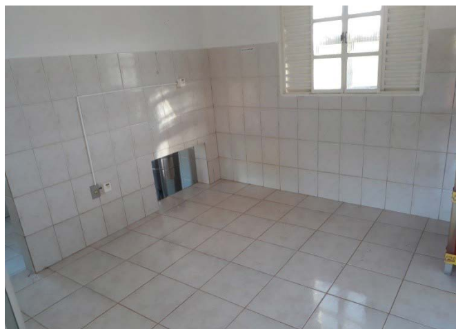
Figura 30. Sala de extração de mel de uma agroindústria de pequeno porte, com destaque para o piso e paredes revestidos com material de fácil higienização. Fonte: Arquivo pessoal – Débora C. S. de Assis.
