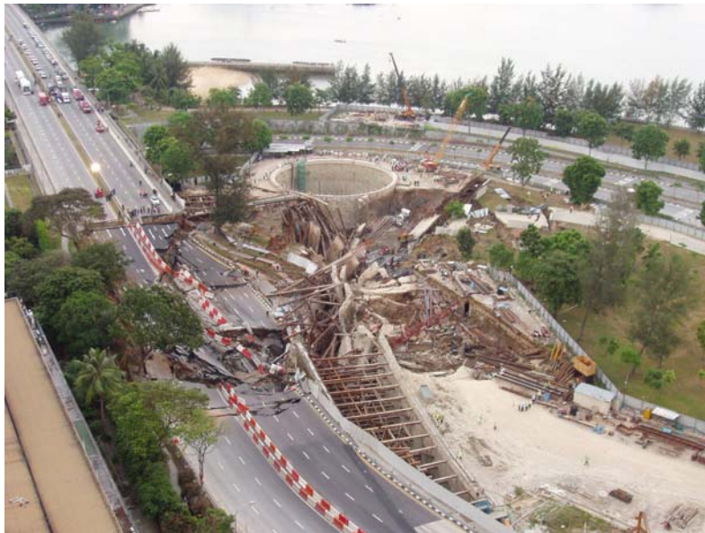
Figura 28. Colapso de una excavación para una línea de metro en Singapur
