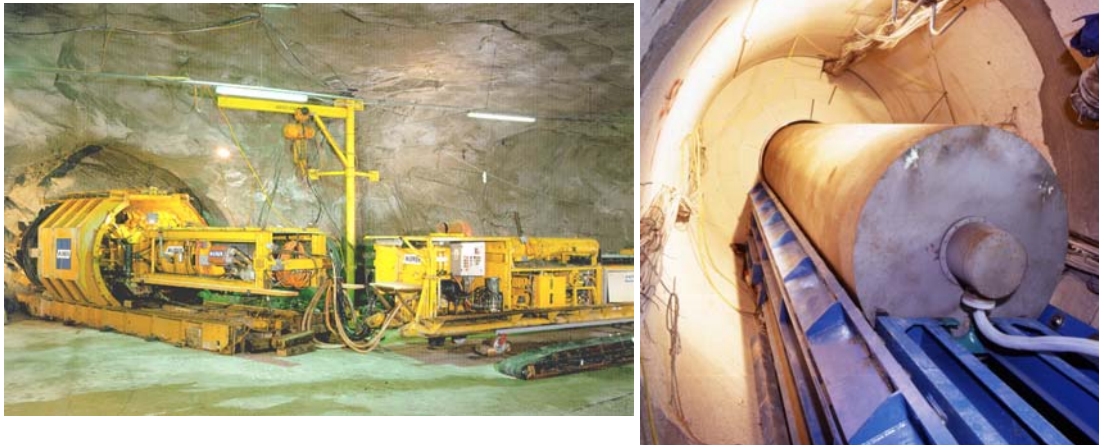
Figura 44. Ensayo Febex realizado en el laboratorio subterráneo de Grimsel para simular el concepto español de almacenamiento geológico profundo. Excavación del túnel e instalación del calentador, alrededor del cual se observa la barrera de bloques de bentonita compactada
