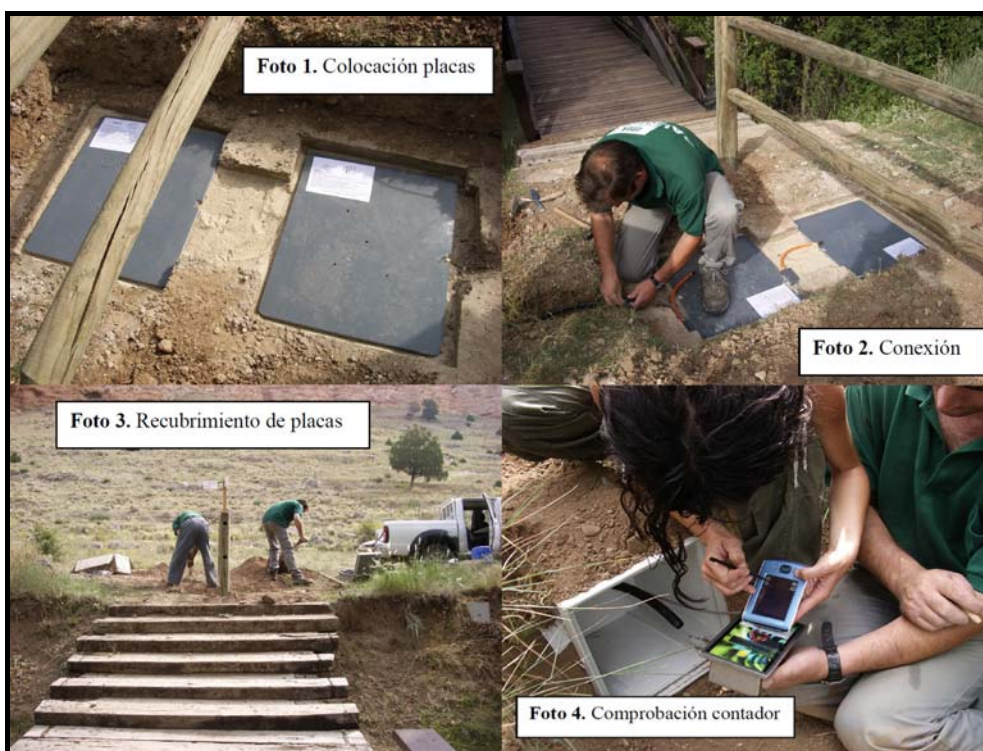
Figura 5.3: Proceso de instalación de un equipo de medición del aforo peatonal en la Senda del Castañar de la Reserva Natural del Valle de Iruelas. Este equipo está compuesto por una losa acústica y una caja eco-twin, en la que se sitúa el data logger que se encarga de acumular los datos hasta su descarga a través de un Pocket-Pc. Fuente: fotos cedidas expresamente para esta Tesis por el Servicio de Espacios Naturales de la D.G. de Medio Natural de la Consejería de Medio Ambiente de la Junta de Castilla y León.
