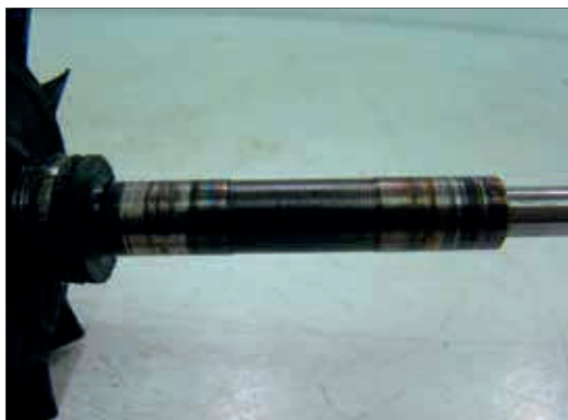
Fig. 22.1.1.2 – Lubrificação deficiente no eixo rotor.
