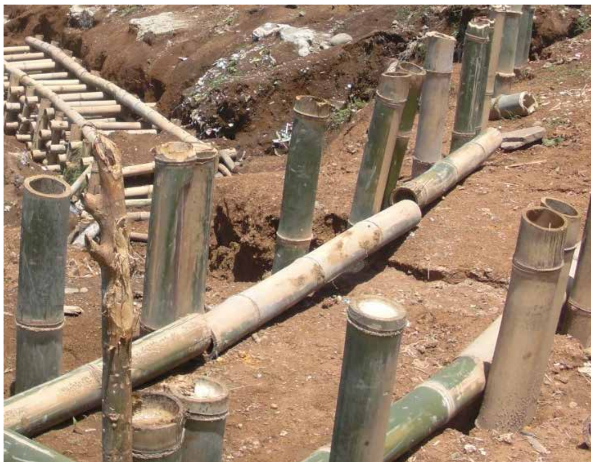
Figura 13. Ejemplo de una Estructura de bambú (troncos longitudinales y verticales). La Palma Sur, La Reforma, San Marcos. Fotografía por: Marvin Rabanales y Ana Reyna.
