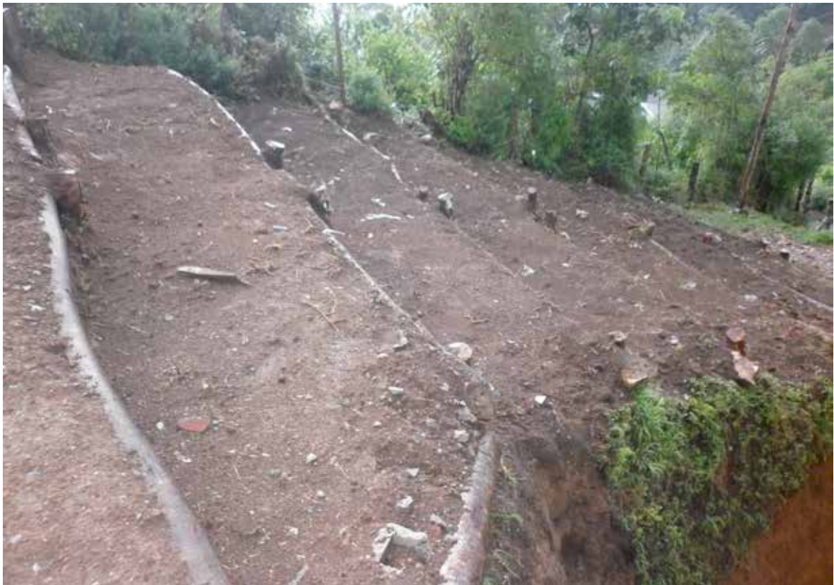
Figura 11. Ejemplo de un armado de terrazas (Entramado de madera vivo a doble pared). El Carrizal, Esquipulas Palo Gordo, San Marcos. Fotografía por: Marvin Rabanales y Ana Reyna.
