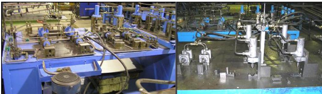
Figura 3. 23 - Sistemas Hidráulicos de Furação.
