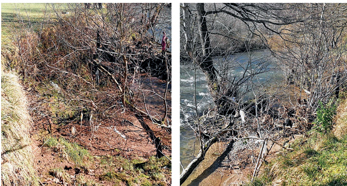
Aspecto inicial de la zona erosionada
