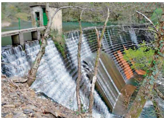
Presa de Inturia antes de la demolición, durante y finalizada la misma
