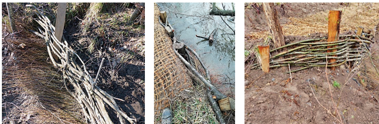
Detalle del trenzado y de las ramas antierosivas, colocación de malla para proteger el trenzado y detalle de terminación lateral
