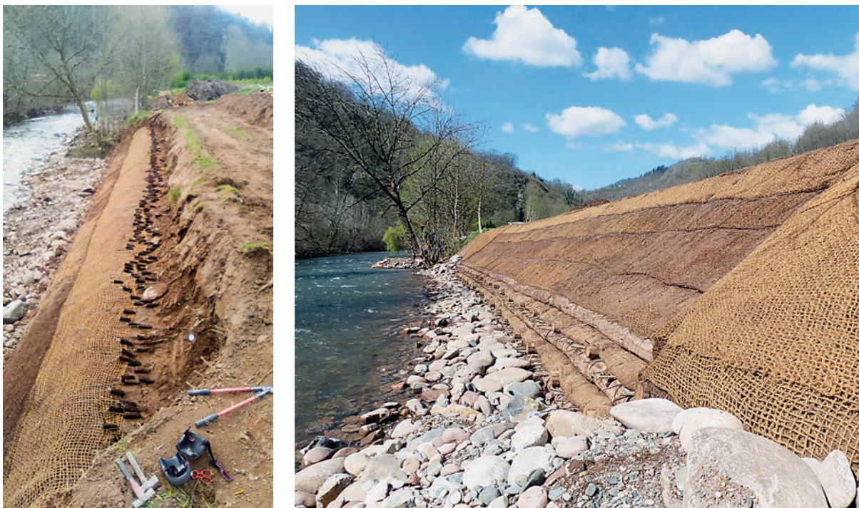
Colocación de la planta en alvéolo forestal e imagen de la obra terminada
