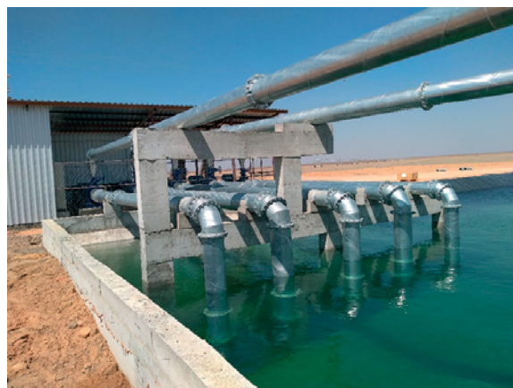
Figura 5 – Sistema de captação de água
