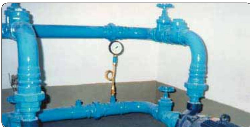
Foto 7 — Estação elevatória de água tratada
