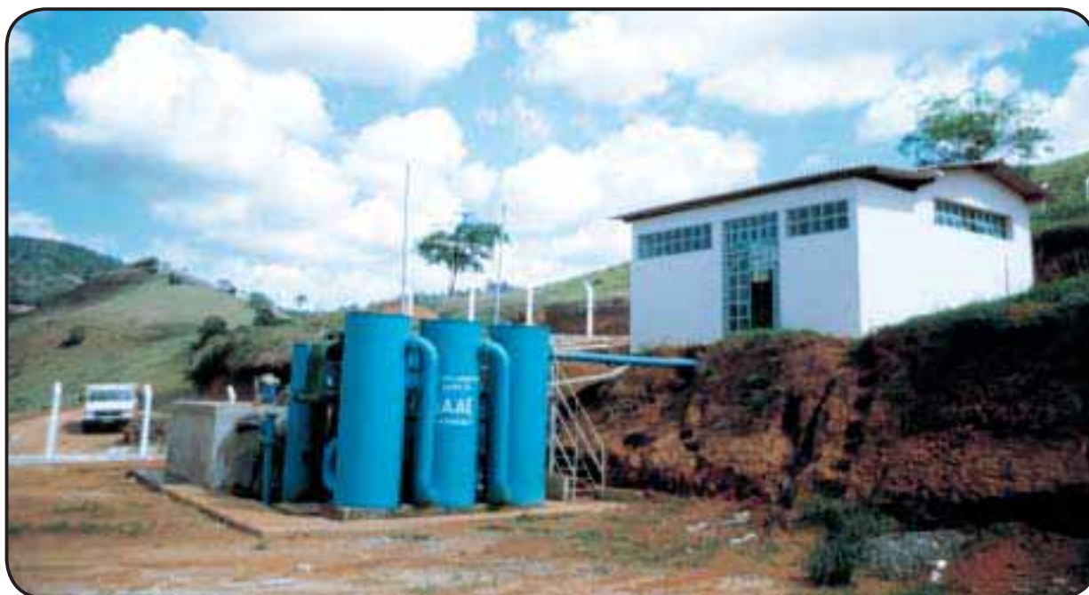
Foto 4 — ETA compacta com casa de química
