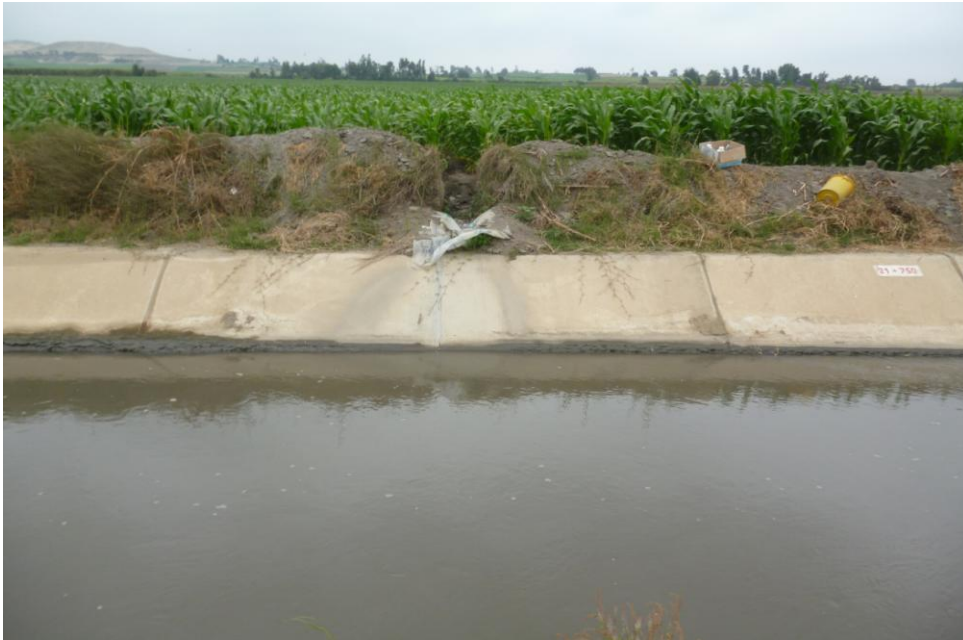
Fig. N° 66 Se observa un desagüe artesanal en el canal Chimbote.
