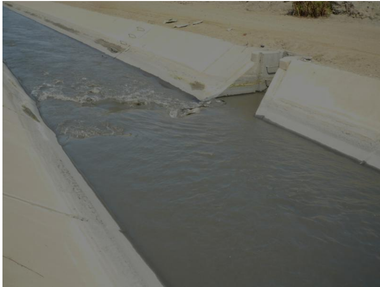
Fig. N° 73 Se observa la captación del agua en el canal Chimbote.
