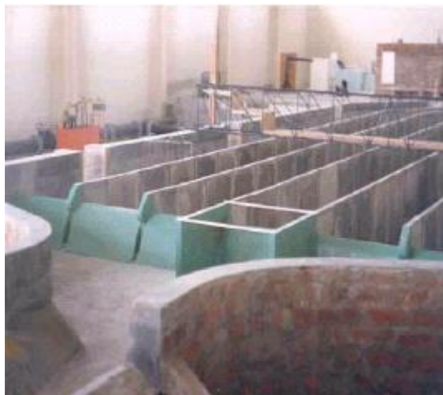
Fig. N° 56 Se muestra los vertederos que establecen el nivel de agua en las naves desarenadoras
