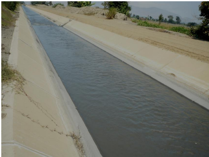
Fig. N° 75 Se observa la captación del agua en el canal Chimbote.
