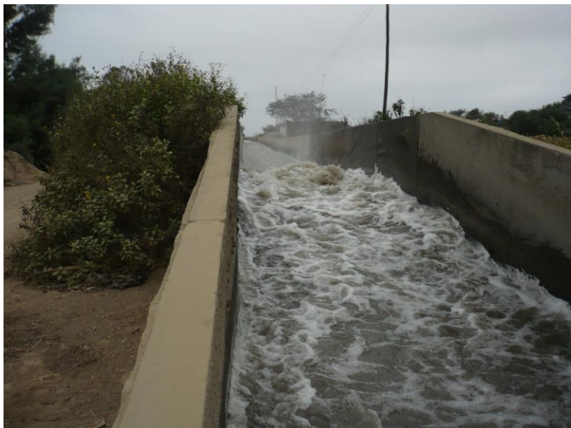
Fig. N° 70 Se observa el flujo de tipo supercrítico.
