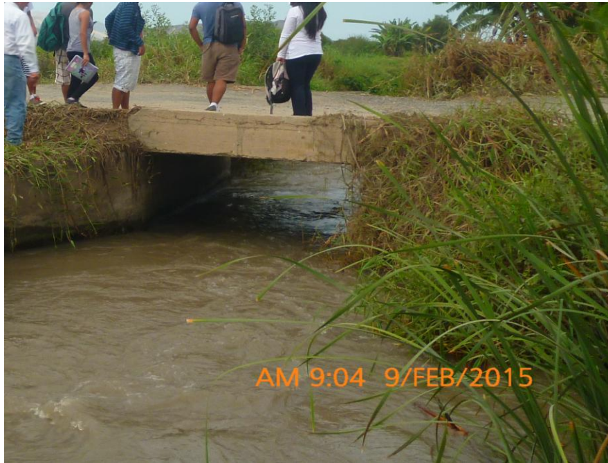
Fig. N° 80 Se muestra una alcantarilla que traslada las aguas del dren tambo real.
