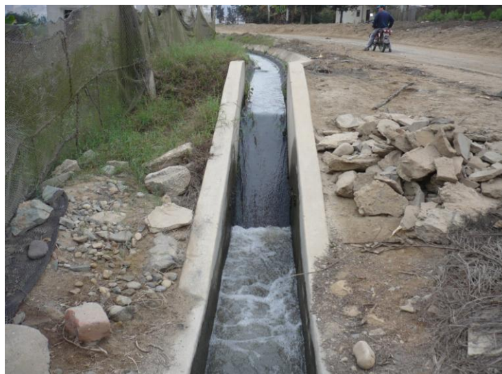
Fig. N° 77 En la vista se observa una caída inclinada en un canal lateral.
