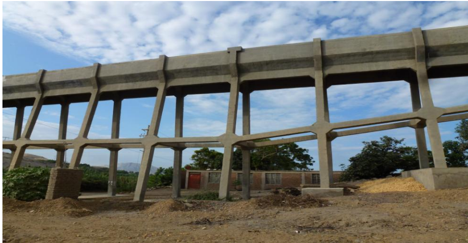
Fig. N° 84 Se muestra el acueducto del canal Chimbote a la entrada del distrito de cascajal.
