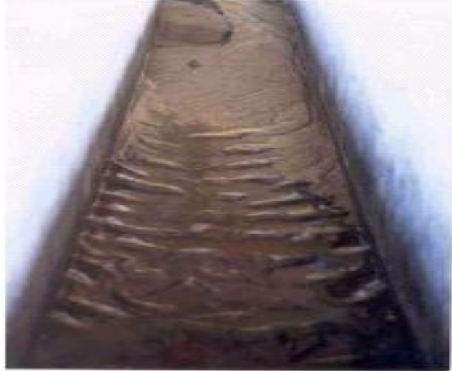
Fig. N° 57 Se muestra la acumulación de sedimentación en una de las naves del desarenador.
