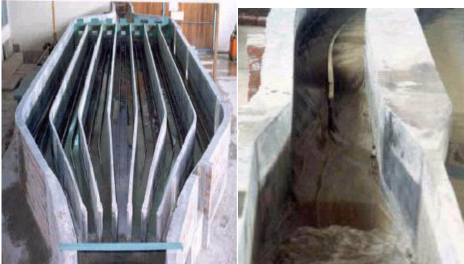
Fig. N° 61 Se observa el proceso de funcionamiento del desarenador.
