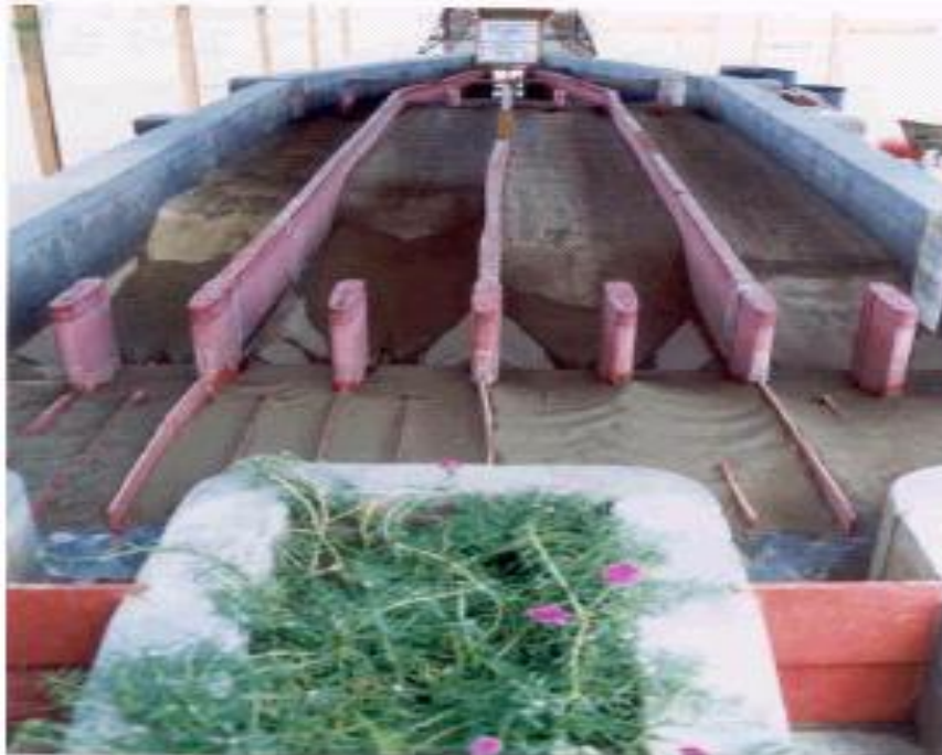
Fig. N° 63 Se observa el proceso de funcionamiento del desarenador
