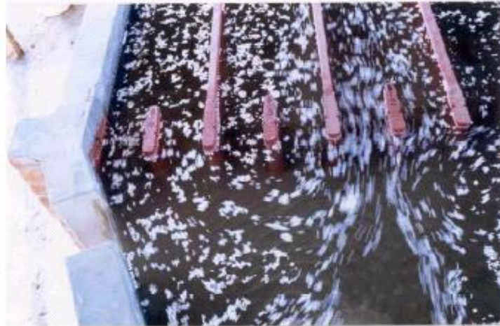
Fig. N° 60 Se observa el proceso de funcionamiento del desarenador.
