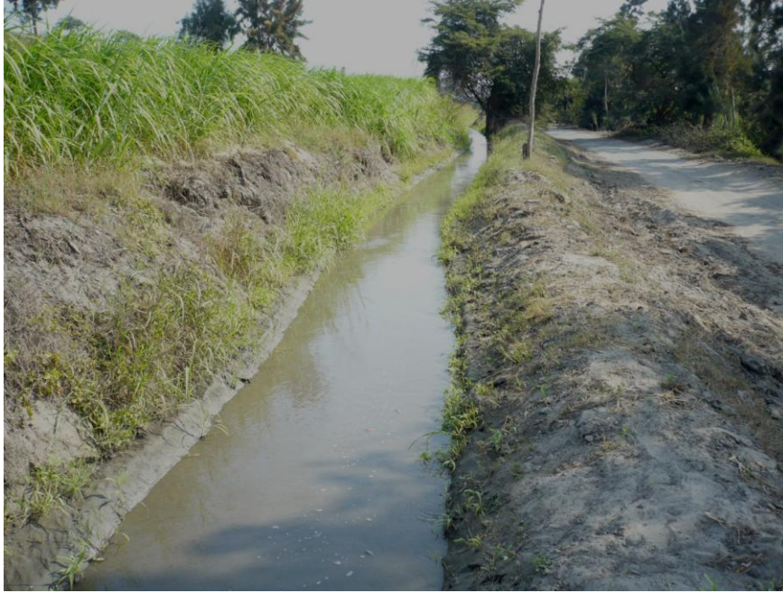
Fig. N° 74 Se observa el canal no revestido la mora.
