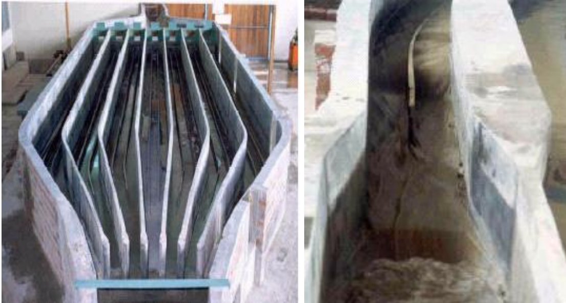
Fig. N° 62 Se observa el proceso de funcionamiento del desarenador
