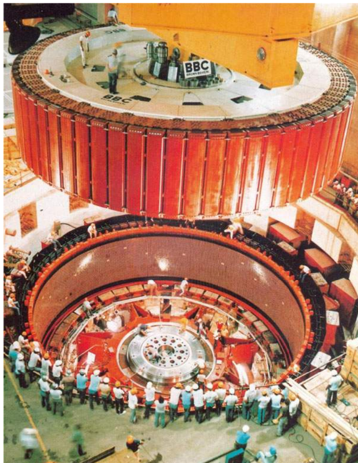
Fig. 26: Hidroalternador síncrono trifásico de la central de Itaipú de 824 MVA, 90 r.p.m., 60 Hz (Fuente: Revista ABB, n° 1, 1992).
