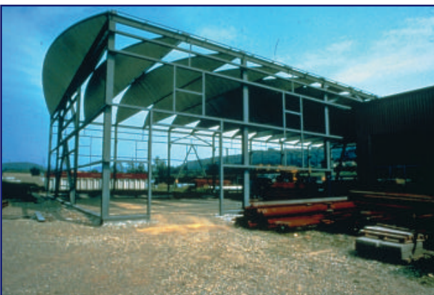
T2c22 Nave almacén Jakem, Munchwilen, Aargau, Suiza
