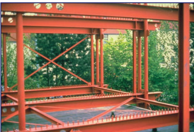
T2c128 Arriostramientos en cruz dan rigidez lateral. Edificio de oficinas en Alemania
