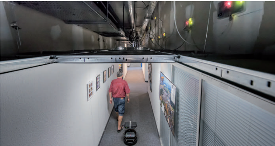
Red de sensores FIT/IoT Lab instalada en el centro de investigación Inria Grenoble Rhône-Alpes. © Inria/Photo H. Raguet.
