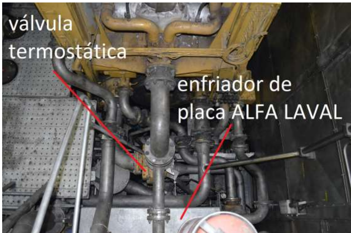
Ilustración 52. Válvula termostática y placa Alfa Laval. Fuente: Trabajo de campo
