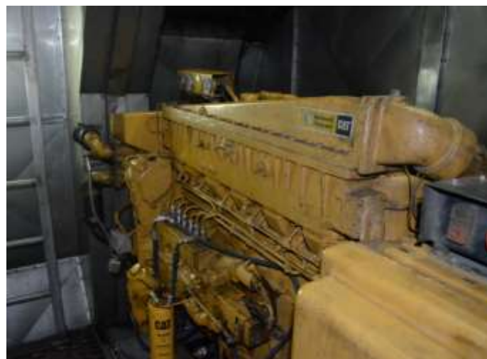
Ilustración 13 Motor auxiliar. Fuente: Trabajo de campo
