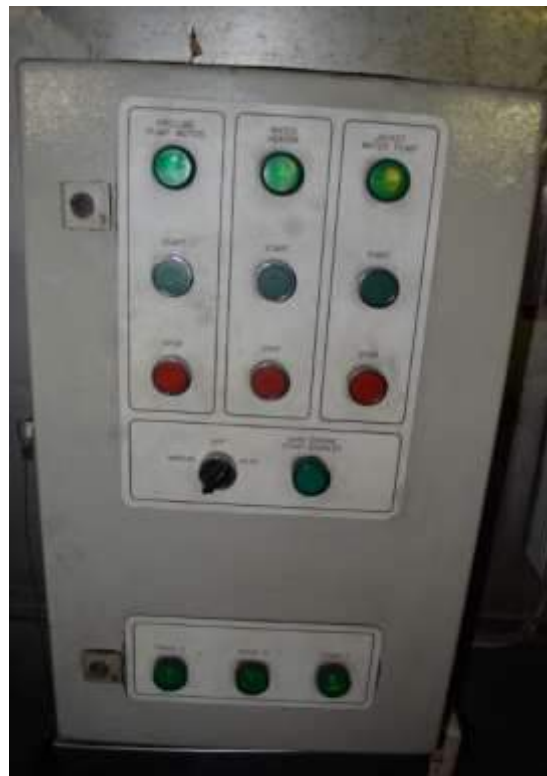
Ilustración 60. Panel de control de bombas eléctricas. Fuente: Trabajo de campo
