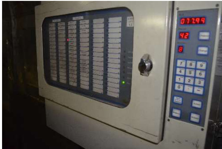
Ilustración 61: Cuadro de alarmas de moderación. Fuente: Trabajo de campo
