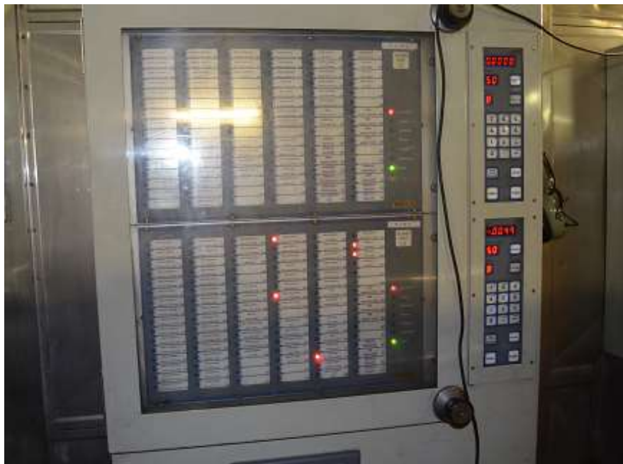
Ilustración 62: Cuadro de alarmas PIME y POME. Fuente: Trabajo de campo
