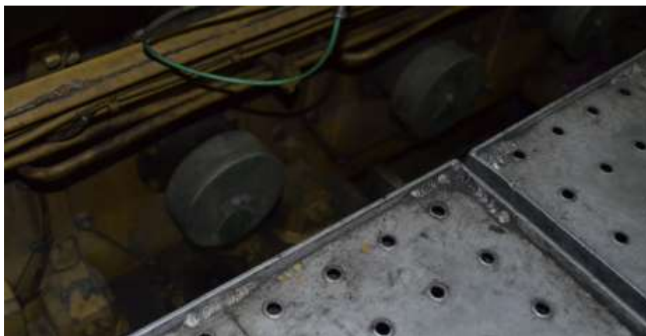
Ilustración 20. Válvulas de alivio. Fuente: Trabajo de Campo
