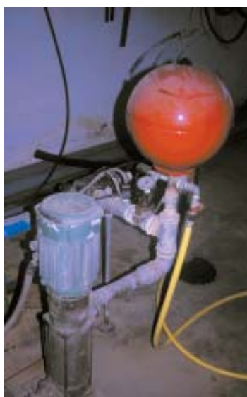
Figura 9. Equipo de bombeo con calderín.
