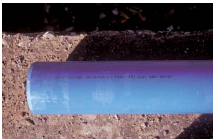
Figura 9. Detalle de las características técnicas impresas en una tubería de PVC.
