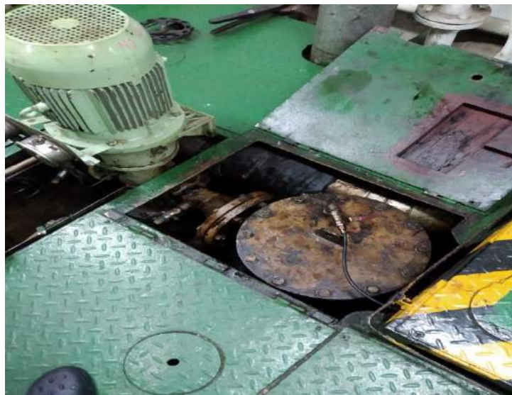
Ilustración 11: Filtro de aspiración bomba de trasiego H.F.O. Elaboración propia.
