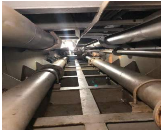
Ilustración 2: Sistema de tuberías de trasiego de fuel oil y gasoil. Elaboración propia.
