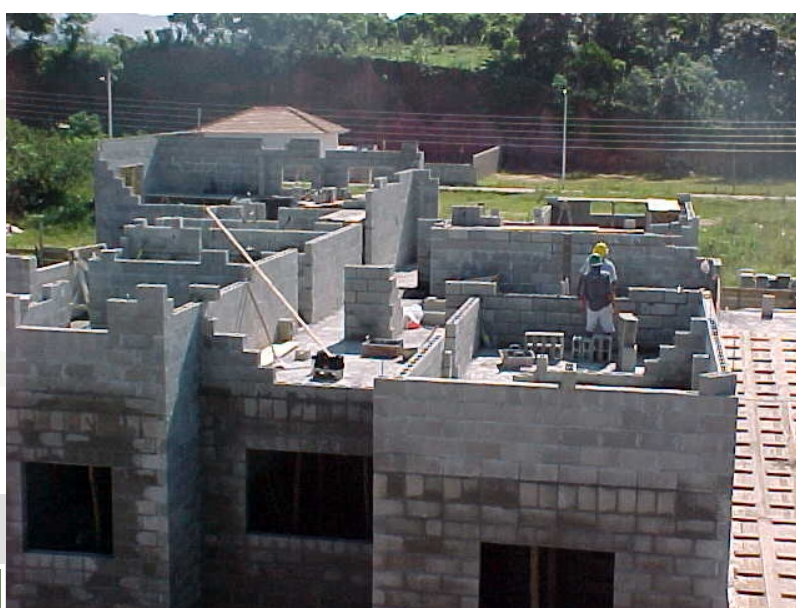
Figura 145 - Elevação não homogênea das paredes
