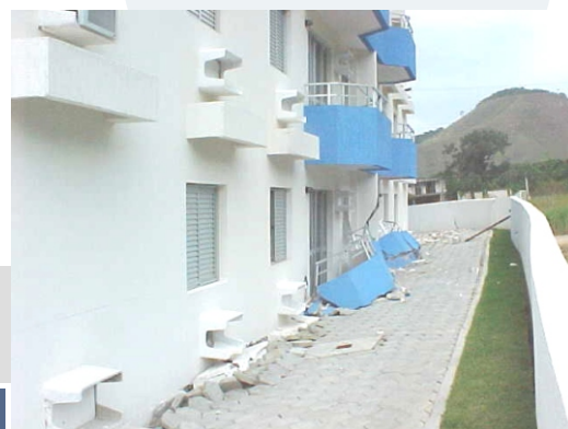
Figura 89 - Prédio colapsado sobre andar de pilotis, mantém-se praticamente intacto
