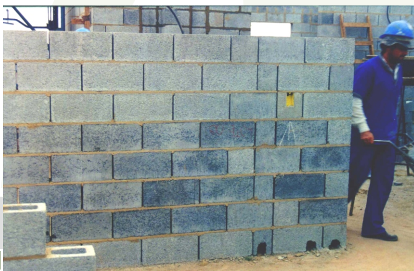
Figura 142 - Parede construída sem a utilização de toda a família de blocos
