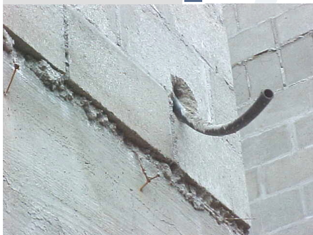
Figuras 103 Excentricidade acidental devido à má execução dos pilotis
