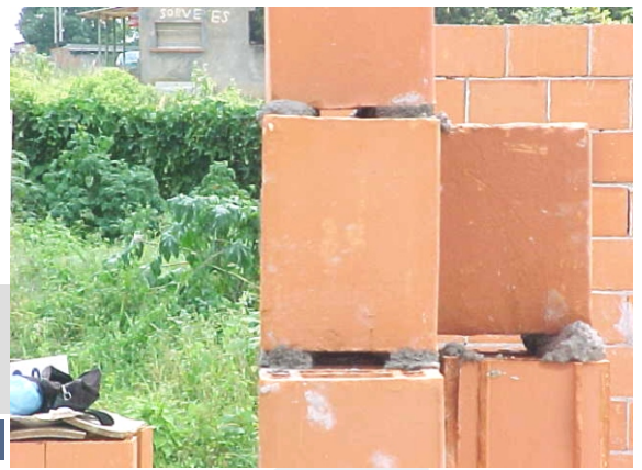
Figura 98 - Junta horizontal preenchida apenas parcialmente e com espessura variável
