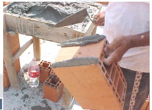
Figura 99 Preenchimento apenas parcial da junta vertical com argamassa
