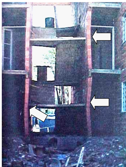
Figura 84 - As paredes que servem de apoio à escada flambaram como se ela não existisse.
