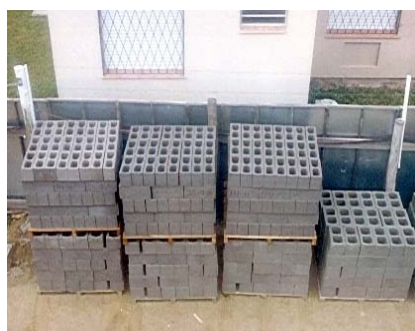
Figura 135 - Armazenamento adequado dos blocos de concreto
