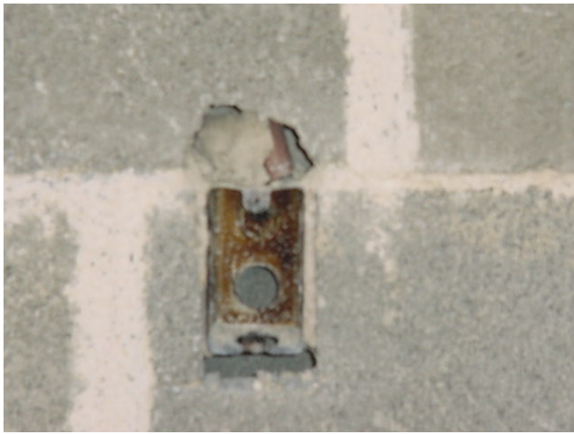
Figura 150 - Quebra em parede resultante de encaixe posterior de eletroduto
