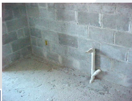
Figuras 73 - a) Tubulação de esgoto da cozinha exposta, prevendo execução de bancada e forro falso na cozinha inferior; b) Bancada contendo as tubulações de água, esgoto e gás.
