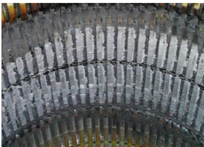
Figura 19. Un roce grave, no reparabile, a menos que el núcleo sea desmontado y reparado.
