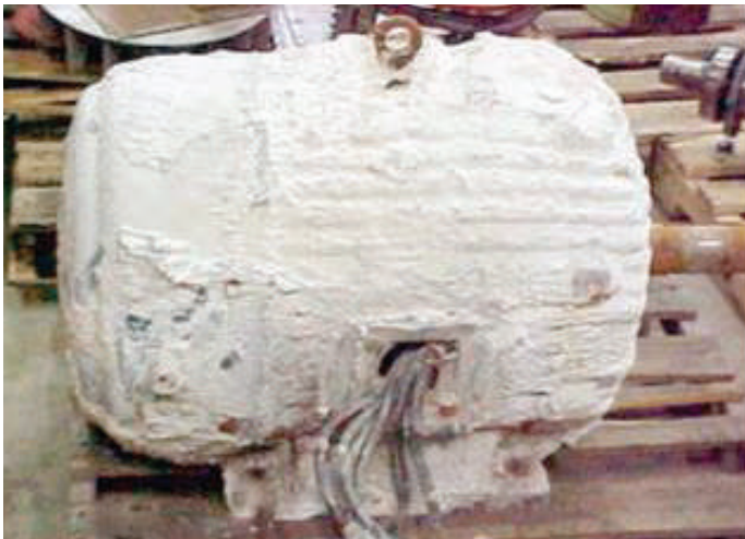
Figura 15. Motor con aletas de enfriamiento obstruidas.
