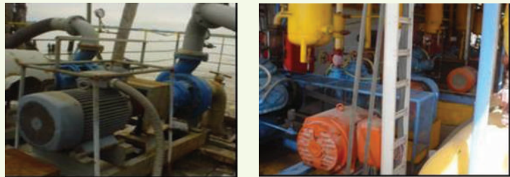
Fig 1. Motores eléctricos conectados a un compresor de refrigeración y a bombas centrífugas
