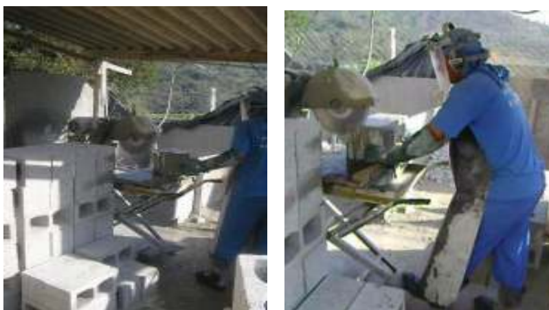
Figura 10 – Corte de blocos para a fixação de caixa de elétrica em central de produção
