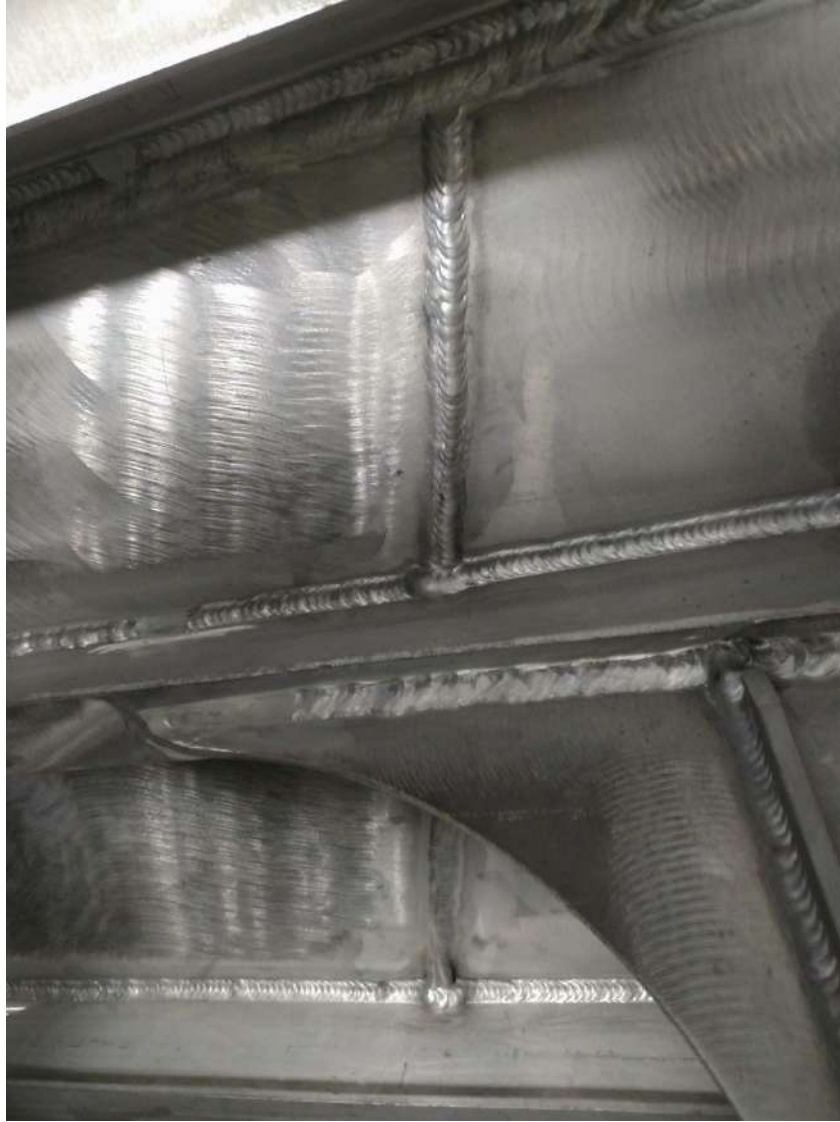
Ilustración 67: Cordones de soldadura en el interior de un módulo, Fuente: fotografías del profesor tutor de este TFG.
