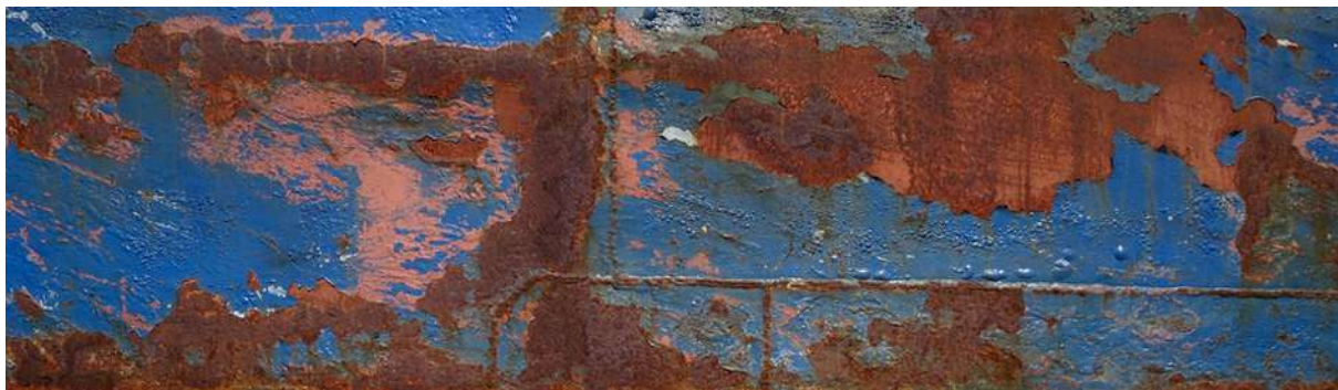
Ilustración 57: Corrosión uniforme en un casco, Fuente: jetdock.com
