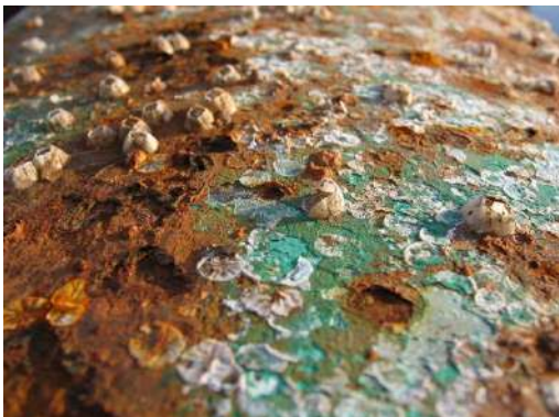
Ilustración 58: Corrosión microbiónica Fuente: berkeyyagua.es
