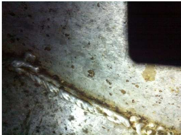
Ilustración 64: Corrosión por picadura en aluminio naval, fuente: cruisersforum.com
