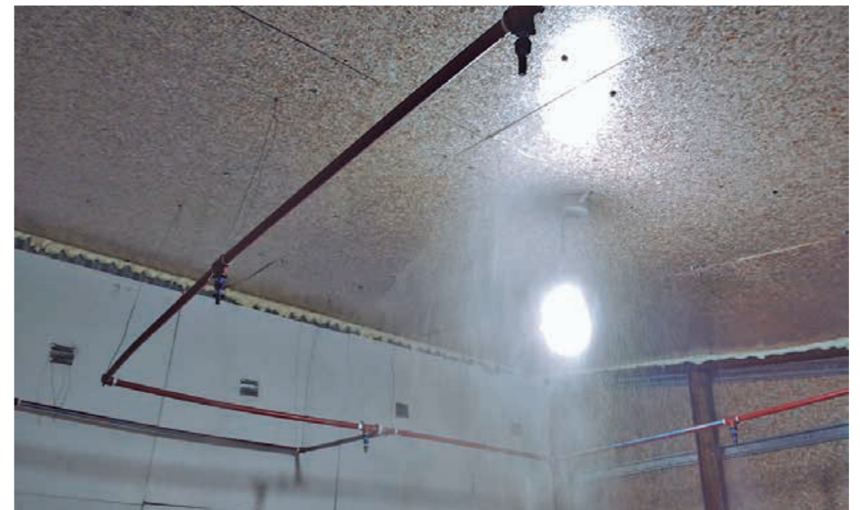
Imagen 16. Sistema de aspersores automáticos.
