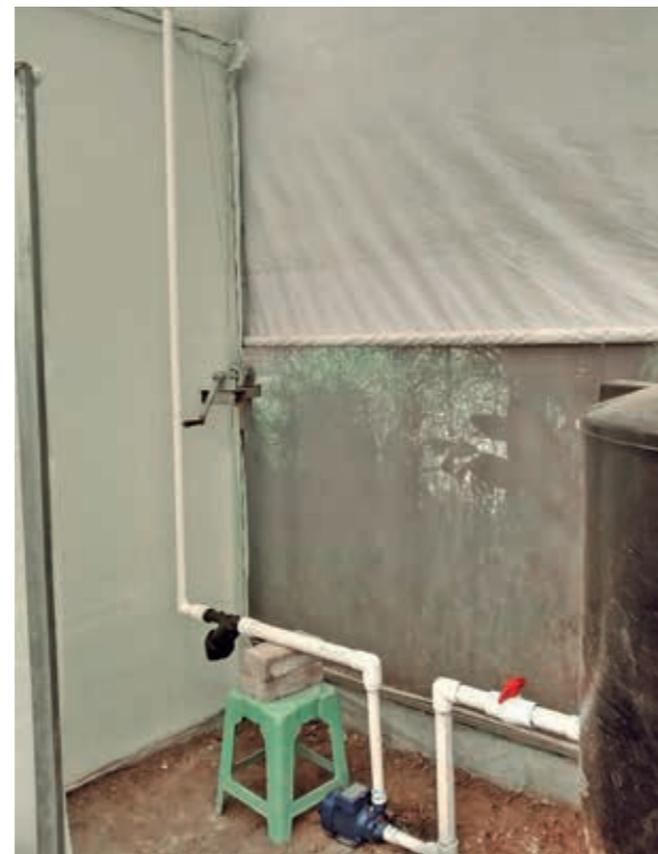
Imagen 15. Sistema de bomba para aspersores automáticos.
