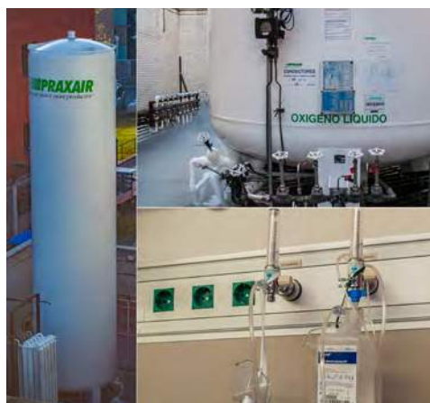
Figura 1. Central de oxígeno. Tanque criogénico
