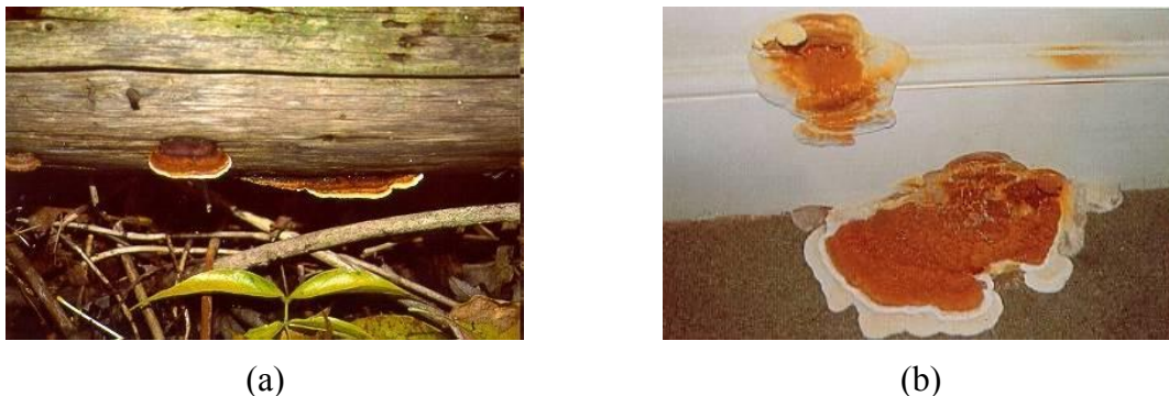
Figura 2 – Biodegradação ou biodeterioração; (a) Fungo de podridão seca em meio natural - biodegradação; (b) Fungo de podridão seca na construção - biodeterioração.
