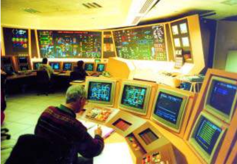
Sala de Control de una central nuclear
