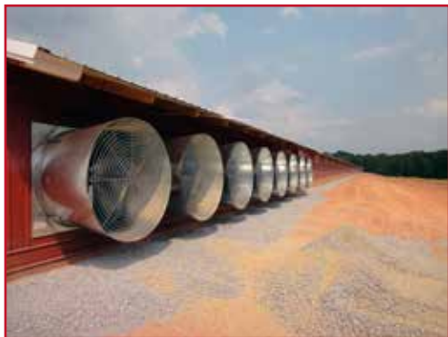
Figure 6.13 : exemple type d'un bâtiment équipé d'une ventilation en tunnel.
