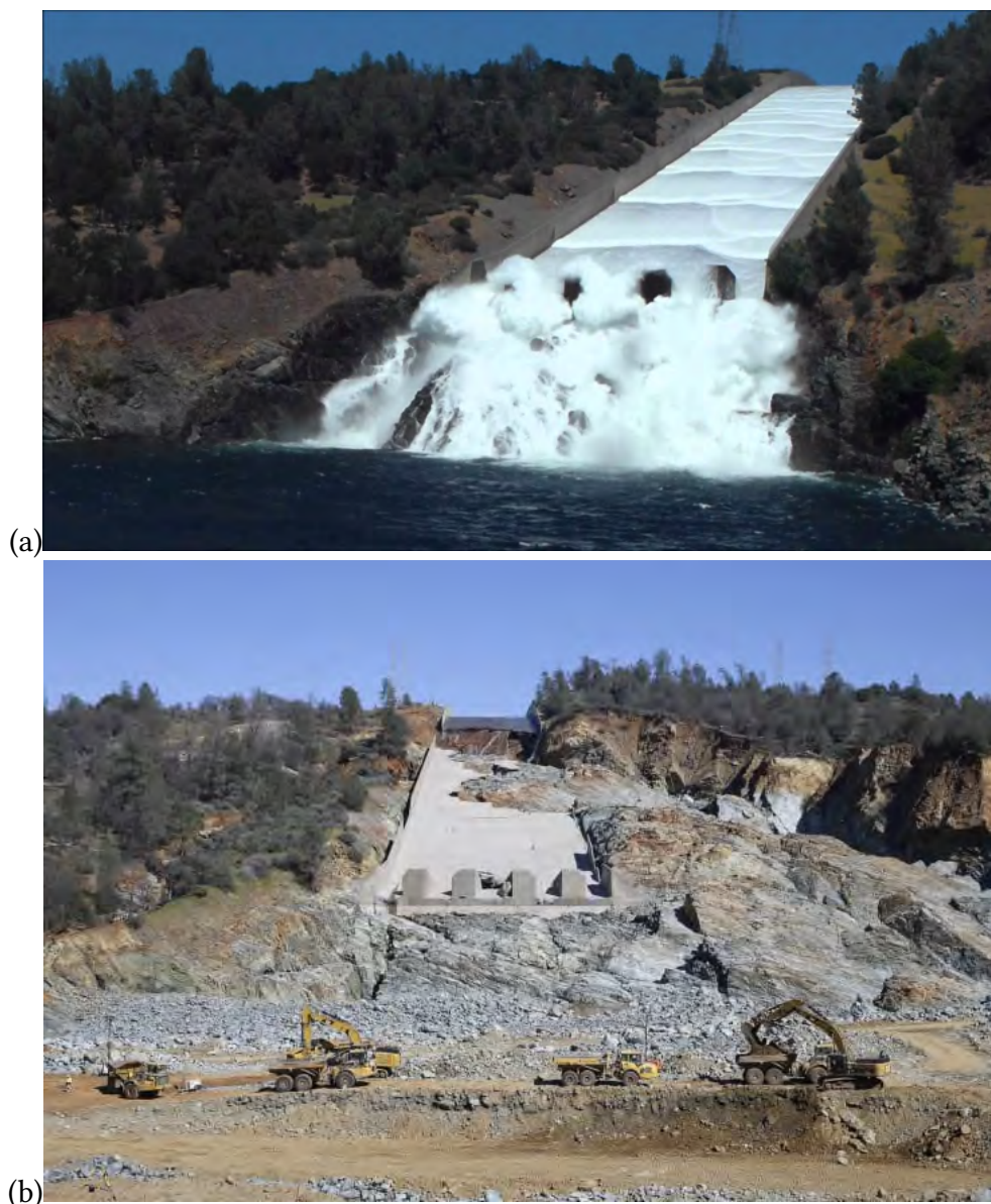
Figure 5.43 : évacuateur de crue du barrage d'Oroville (Californie) avant (a) et après (b) la crue de février 2017. Source : Rich Pedroncelli .
