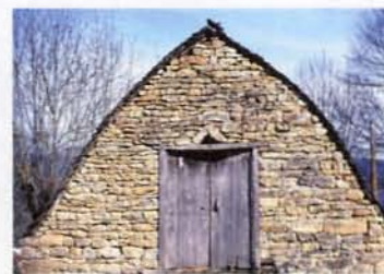
La charpente «à la Philibert» est rigoureusement transcrite dans cette toiture aveyronnaise.
