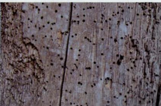
La présence d'insectes dans le bois se repère tout d'abord aux trous d'entrée et de sortie et à la sciure issue de leur cheminement dans le bois.
