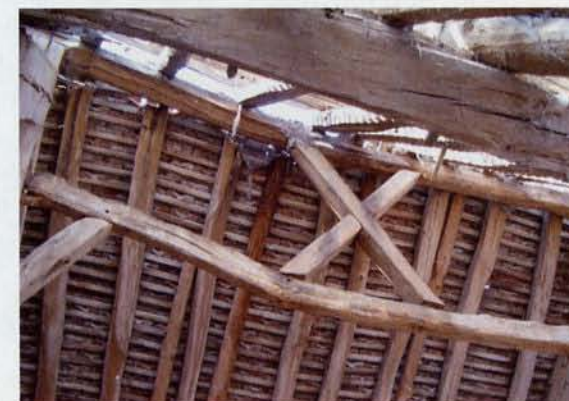
Le fléchissement important du sous-faitage n'a pas entraîné sa rupture mais a provoqué la dislocation de l'assemblage dans le poinçon de la ferme, à gauche.
