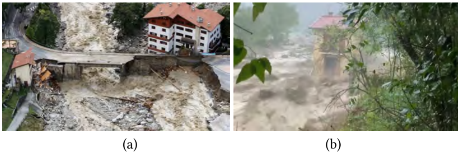
Figure 2.2 : (a) vue aérienne du pont sur la Vesubie à Saint-Martin-Vésubie (Alpes-Maritimes, France) le 3 octobre 2020 et (b) maison à Roquebillière emportée par la Vesubie. Le 2 octobre 2020, la tempête Alex a déversé 200 à 400 mm de pluie sur quelques heures sur le Mercantour, causant des crues majeures de la Roya et de la Vesubie.
