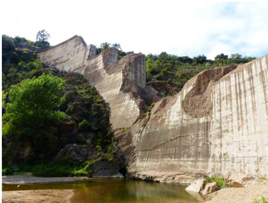
Figure 3.17 : brèche dans la voûte du barrage de Malpasset. Source : www.wikiwand.com .
