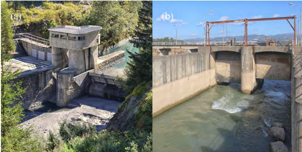
Figure 1.11 : différents types de vanne. (a) vanne secteur sur la Dranse à Fionnay (VS); (b) vanne plane sur l'Alphée à Olympie (Grèce).
