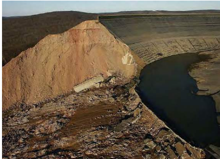
Figure 3.2 : vue de la brèche dans le remblai du barrage de Taum Sauk.
