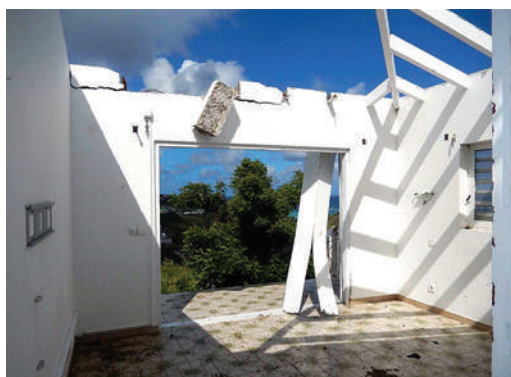
Figure 13 : Mauvais assemblage à la maçonnerie et absence de contreventement pour une charpente à 4 versants
