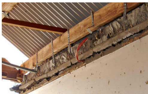
Figure 11 : Mauvaise fixation (plats mal ancrés)
