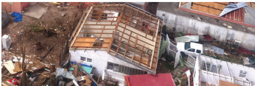
Figure 4 : Absence de contreventement
