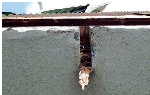
Figure 10 : Mauvaise fixation de la charpente au chaînage
