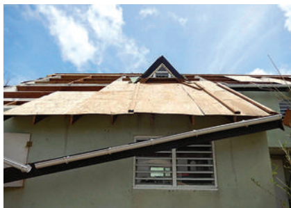
Figure 3 : Espacement des pannes trop important
