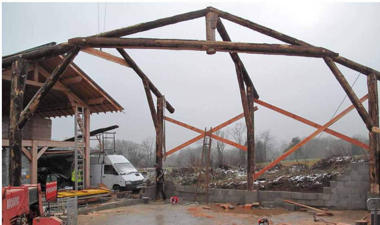
△ La partie en angle du bâtiment est en place : les contrevents et les demi-charpentes posées sur la noue stabilisent cette partie de la structure.
