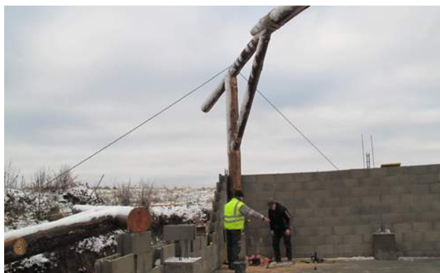
△ Mise en place du système de cordes qui stabilisent provisoirement la charpente qui est une noue (voir glossaire).
