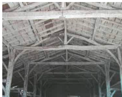
△ Exemple de charpente ancienne (Source : Maisons paysannes de France, n° 191, printemps 2014, p. 15.)
