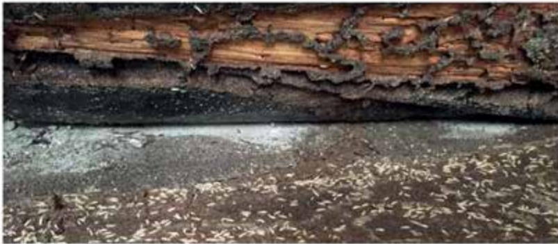
Infestation sous une poutre
