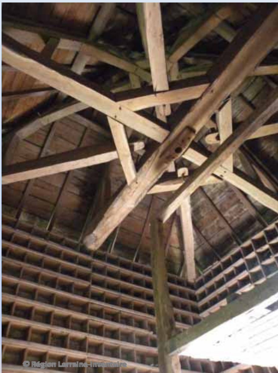
Enrayure sur bâtiment carré, 54-Bicqueley.
