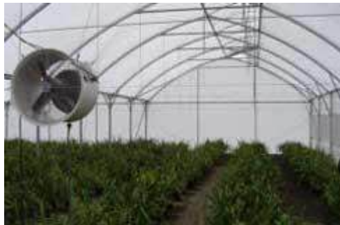
Figura 7. Ventiladores de flujo lateral
