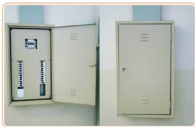
Figura 4.7: Quadro de distribuição com seus disjuntores
