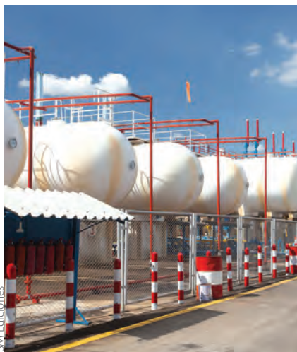
Planta de gas natural.
