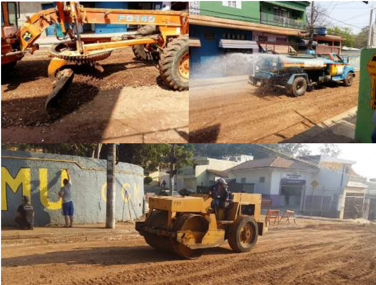
Figura 47 - Sequência de execução de uma subbase de pavimento flexível com bica corrida reciclada.
