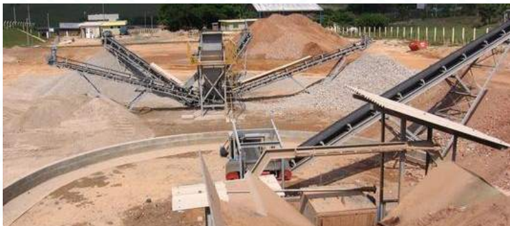
Figura 11 - Usina fixa com configuração bem simplificada (greiha, britador, combinado ou não com peneira). Pode-se obter tipos diferentes de agregados reciclados; bica corrida mista (para pavimentação) ou agregado cimentício classificado (pedrisco, rachão), solo escalpado (não classificado por tamanho). Fonte da imagem: https://www.sustentaresaneamento.com.br/reciclagem-de-entulhos/
