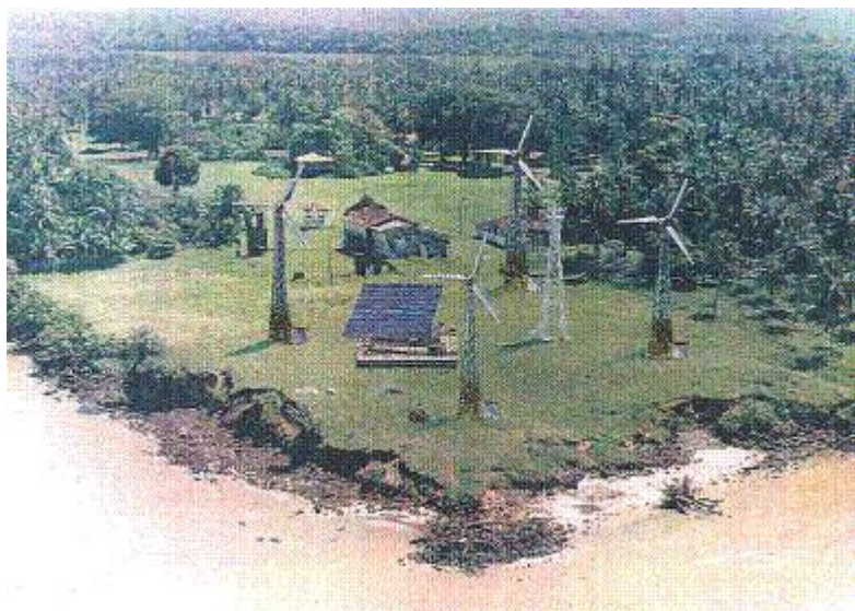
Figura 7.3 - Montagem do sistema híbrido de Joanes.
