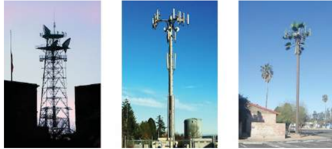
FIGURA 6.4 Las torres de radio y de telefonía móvil se utilizan normalmente para transmitir radiación electromagnética de gran longitud de onda. Cada vez más, las torres de telefonía móvil se diseñan para integrarse en el paisaje, como la torre de telefonía móvil de Tucson (Arizona) (a la derecha), que parece una palmera (créditos: a la izquierda: modificación del trabajo de Sir Mildred Pierce; en el centro: modificación del trabajo de M. O. Stevens).
