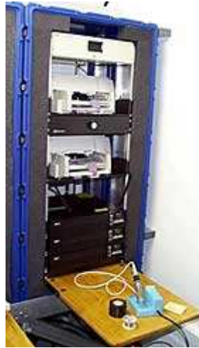
Estante de la UPS y de la impresora con las impresoras de la inyección de tinta y respaldo de la energía del VA 3000.
